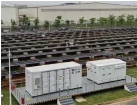
佛山地铁光伏发电项目
