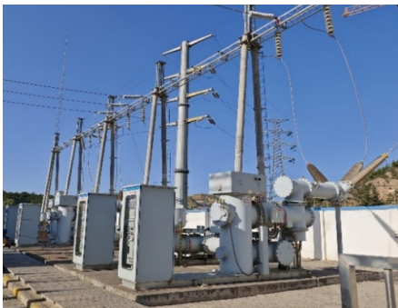
冀南钢铁220kV变电站
