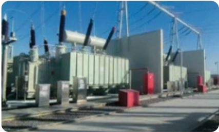
新能源变压器
