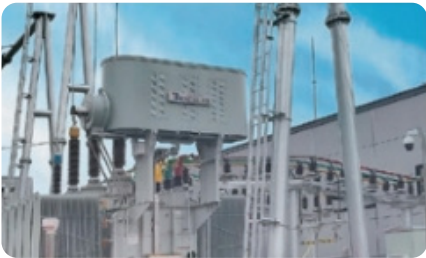
S35-500kV电力变压器
